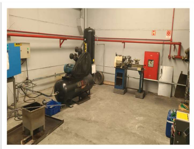
Compressor e depósito da Empresa
