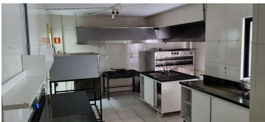
Vista da cozinha industrial do hotel
