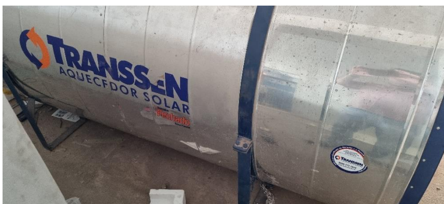
Boiler 2000 litros (duas unidades)
