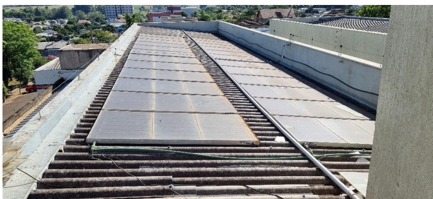
Placas solares de aquecimento de água
