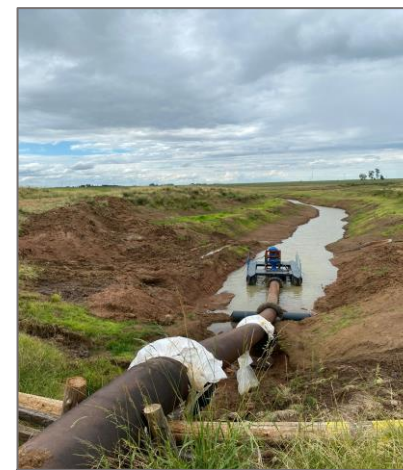
Motor que puxa a água de irrigação das lavouras
