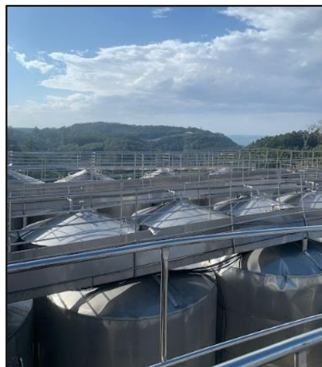
Tanques de armazenamento
