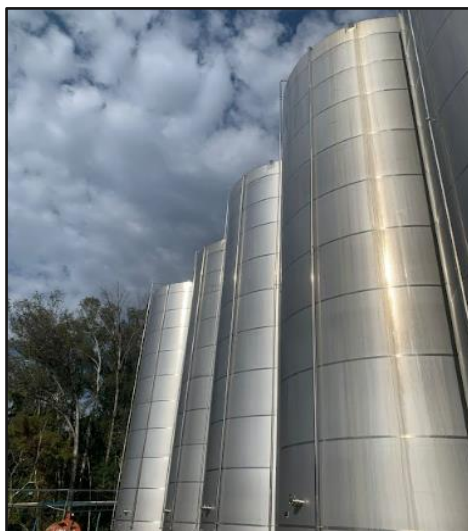
Tanques de armazenamento
